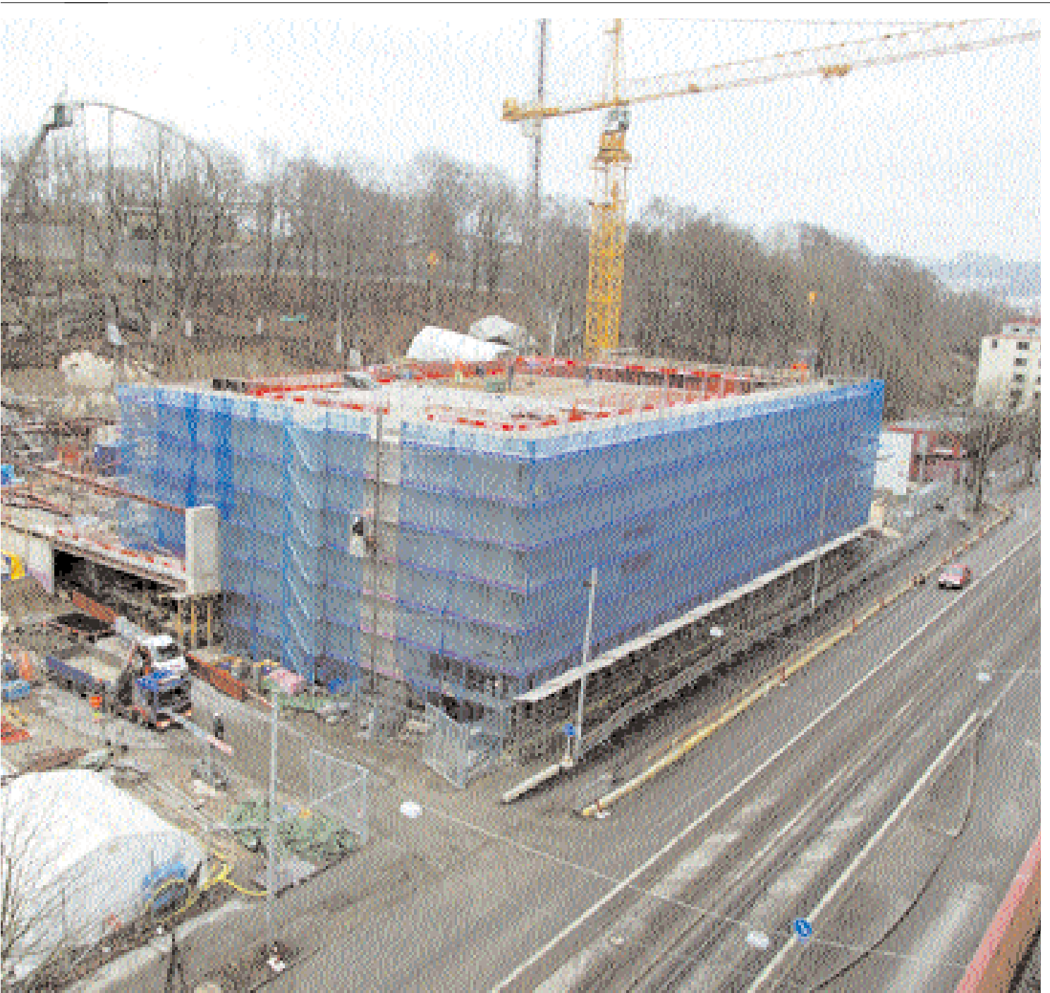
Betongstommen står färdig och byggnadens volym börjar bli tydlig i stadsbilden. I bakgrunden ser man berg och dal-banan på Liseberg.
