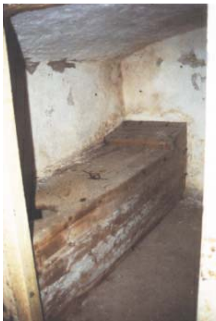
I källaren finns ännu anstaltstidens två isoleringsceller bevarade. Träbritsen med sin 'träkudde' har 'toaletten' inbyggd i fotänden.
