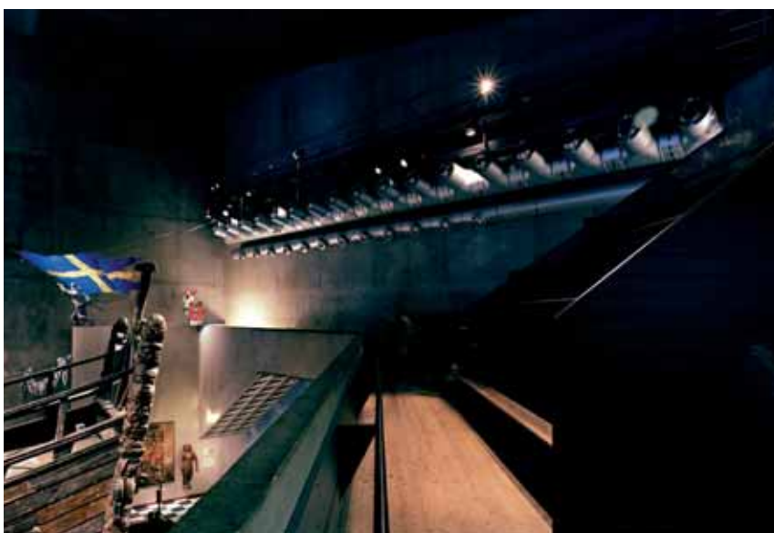
Luftdonen längs västra väggen ser till att skeppets akterparti har rätt klimat.
