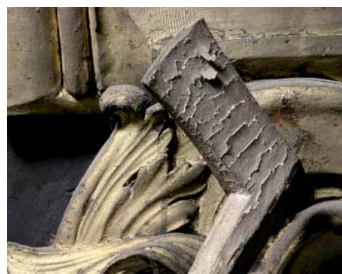
Yxan är tillverkad av trä som målats med limfärg. Färgskiktet flagar kraftigt.
