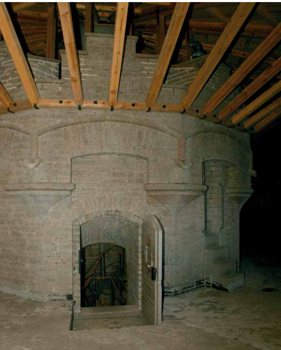
Fredstaket rekonstruerades och återuppfördes 1995 för att hindra det pågående vattenläckaget som orsakat skador i tornets inre.
