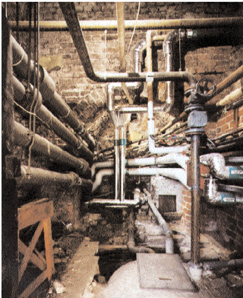
1900-talets bidrag till slottets byggnadshistoria är de tekniska installationerna. De förvandlade efter hand den norra längans medeltida valv till kulvert för slottets försörjningssystem.
