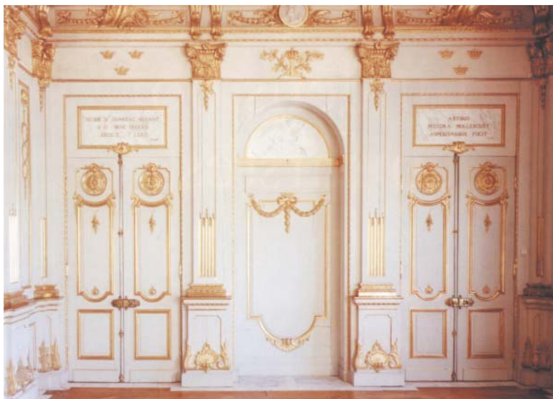
Bibliotekets södra vägg. Lägg märke till ett antal smala sprickor i snickerierna. De stör inte rummets helhet utan visar att vi har ett levande material, trä, som påverkas av rummets klimat.
